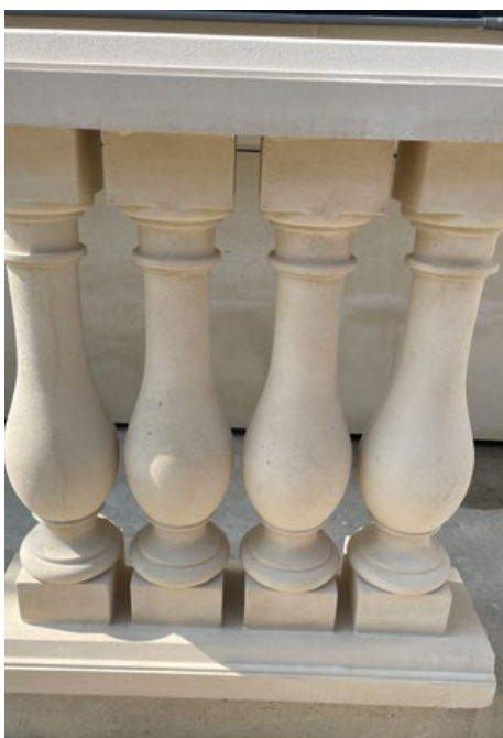
Balustrade : validation des matériaux (pierre, béton), de l'esthétique, des écartements.
